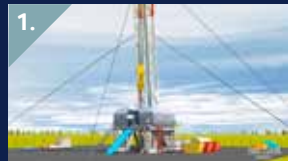
Aufbau der Anlage
